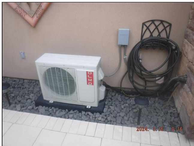
4.9 Item 1(Picture) Mini split A/C unit
