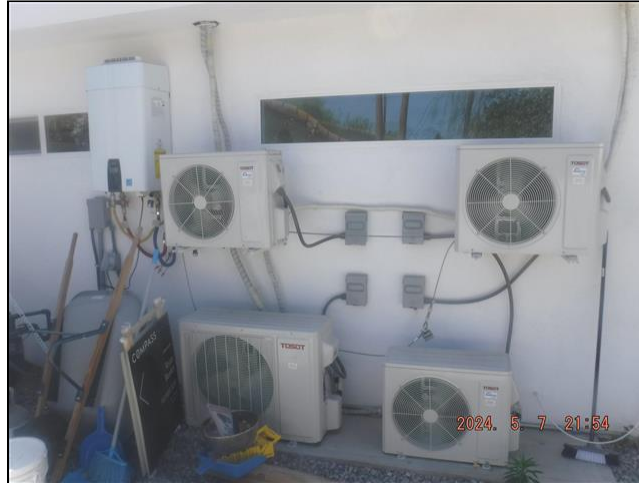
MINI SPLIT AIR CONDITIONING UNITS
